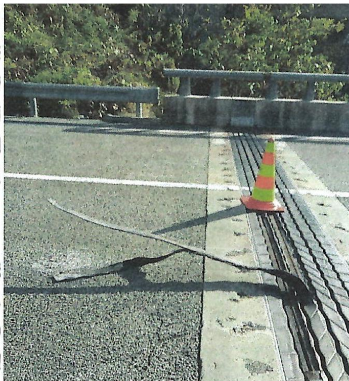
写真1 ■ 破損した東海北陸道の亀尾島川橋のジョイント。長さ約1.9mにわたってめくれ上がった(写真:右も中日本高速道路会社)
