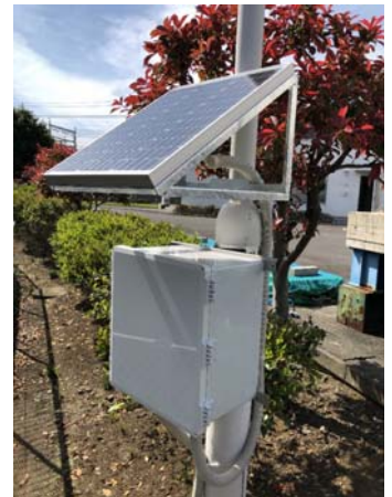
遠隔監視装置
