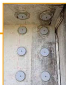
桁側面にサーフェスタ입を設置します。桁端定着部の鋼材腐食を抑制します。
